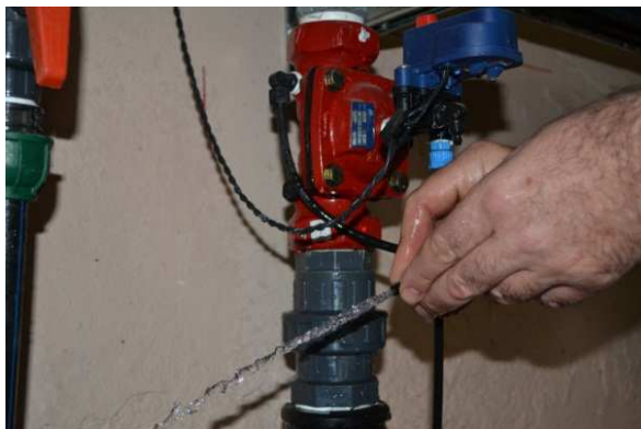
Foto 5: Desguàs del circuit de comandament d'una electrovàlvula.
